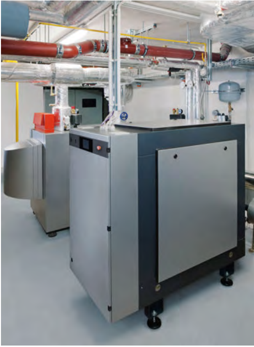
CHP 系统结合高峰负荷锅炉
